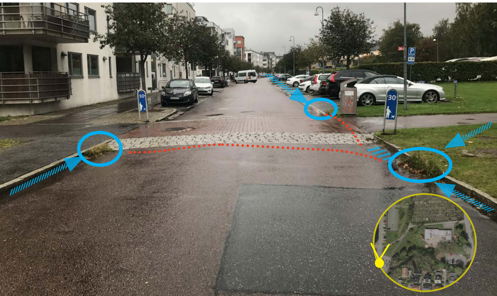
Figur 7. Foto taget i nordlig riktning och visar Mirallén och ett förhöjt övergångsställe. Vattnet från planområdet ansamlades vid en dagvattenbrunn på vägens högra sida, som vid platsbesöket var igensatt av vegetation.
